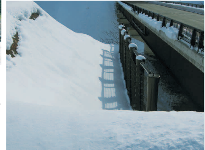
新潟県長岡市山古志神沢川地内 (発注者:北陸地方整備局長岡国道工事事務所)
