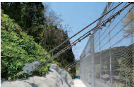
設計条件に応じて山側に控えのアンカーを設置します。
